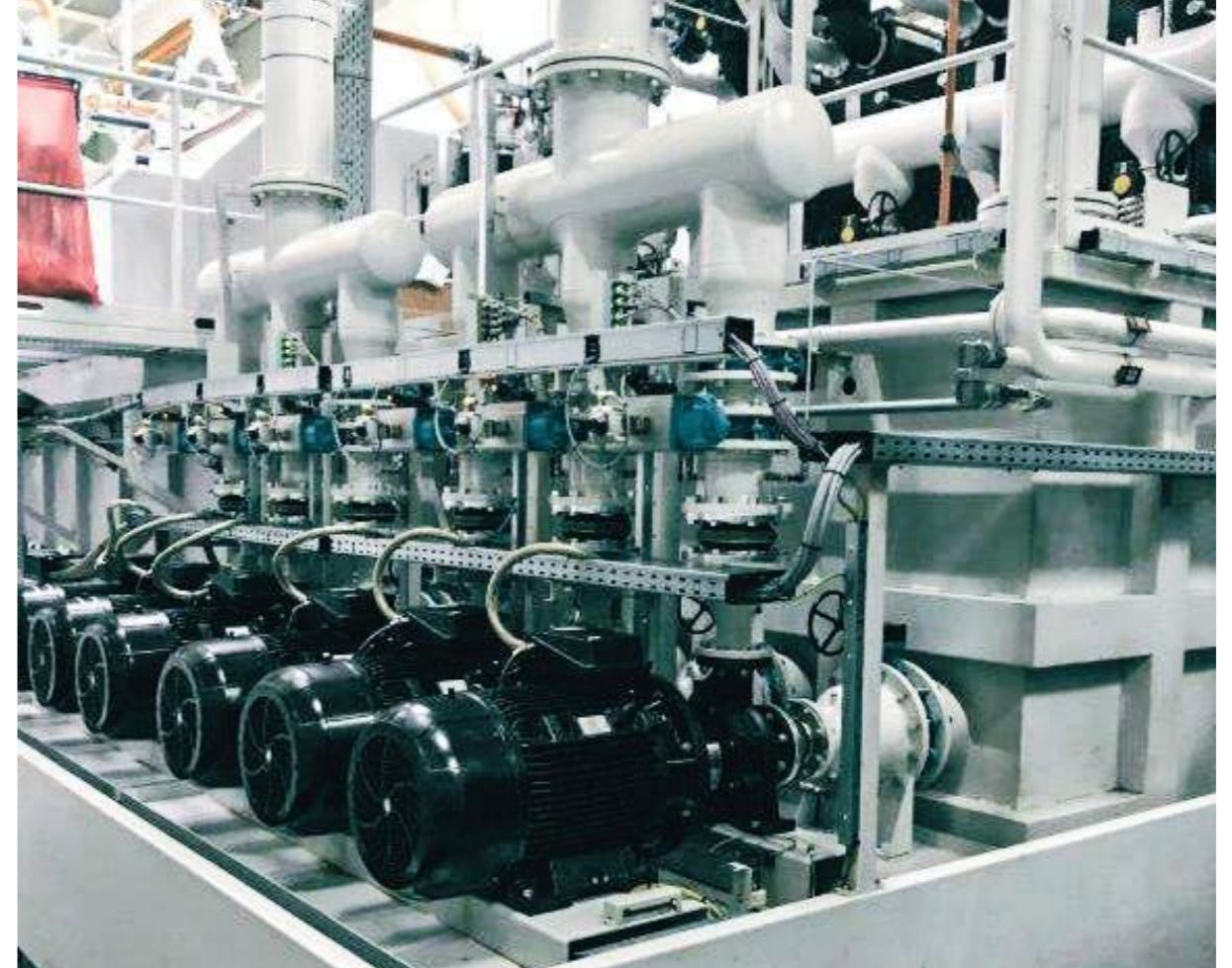
SEKUNDÄRSCHUTZ KÜHLSCHMIERSTOFF ZENTRALANLAGEN
