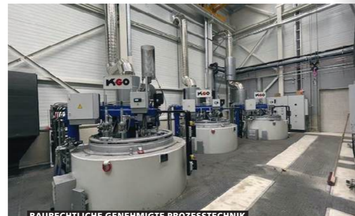
BAURECHTLICHE GENEHMIGTE PROZESSTECHNIK WÄRMEBEHANDLUNG
