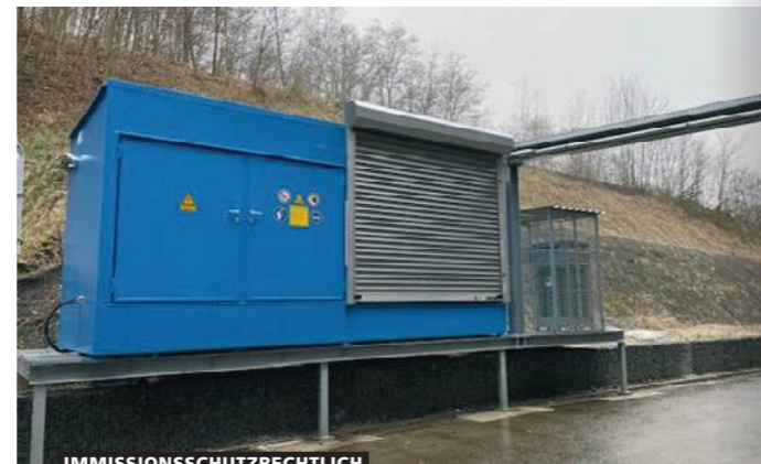
IMMISSIONSSCHUTZRECHTLICH GENEHMIGTE LAGERUNG VON PROZESSGAS
