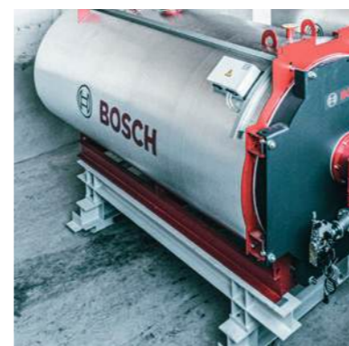
NEU EINGERICHTETE HEIZKESSEL IM HEIZHAUS
