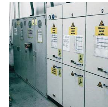
GEFAHRSTOFFSCHRANK MIT TECHNISCHER LÜFTUNG
