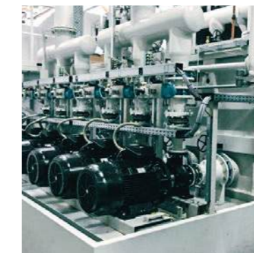
SEKUNDÄRSCHUTZ KÜHLSCHMIERSTOFF ZENTRALANLAGEN
