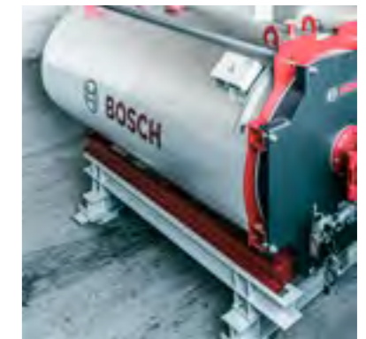
NEU EINGERICHTETE HEIZKESSEL IM HEIZHAUS
