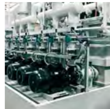
SEKUNDÄRSCHUTZ KÜHLSCHMIERSTOFF ZENTRALANLAGEN
